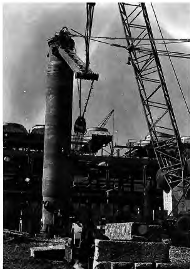
Третьего ноября 1976 года на агрегате аммиака №1 установили первую колонну синтеза весом 450 тонн
